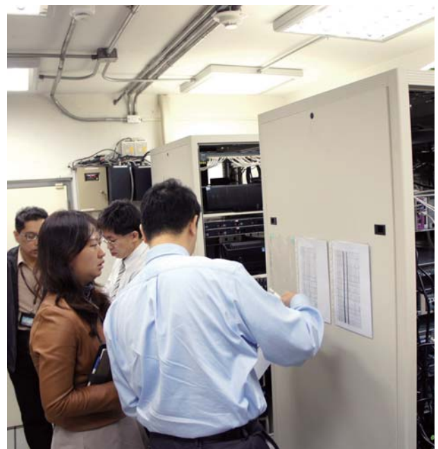
法國標準集團台灣分公司「貝爾國際認證機構」人員檢視本校機房設備
